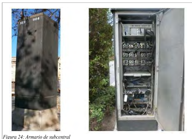
Figura 24: Armario de subcentral
